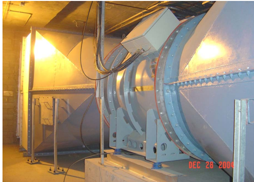
Tunnel Ventilation Fan
