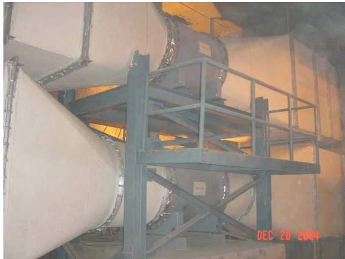
Trackway Exhaust Fan
